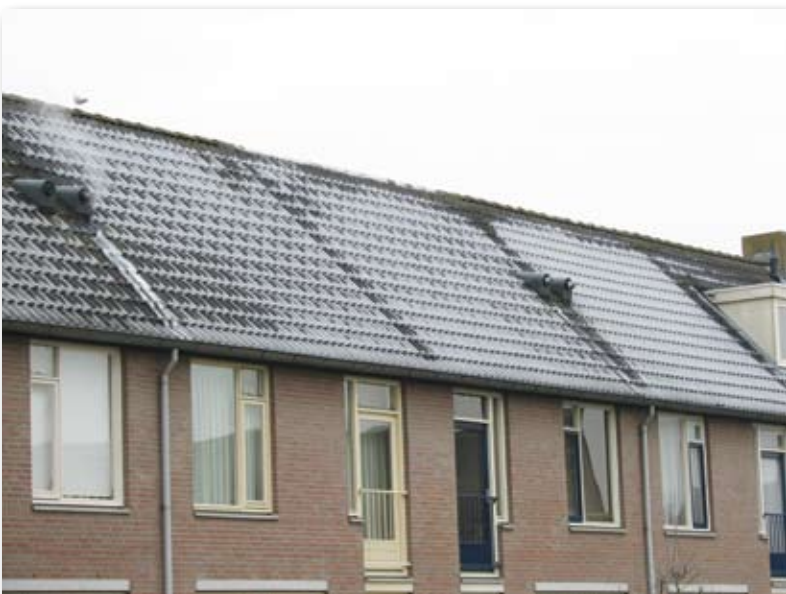
Warme lucht doet in de winter door de lekke aansluitingen de sneeuw op het dak smelten..
