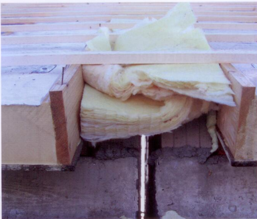
Er is isolatie aangebracht boven de woningscheidende wanden maar vraag niet hoe.
