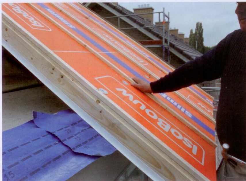
....en de aansluiting is goed verzorgd luchtdicht afgesloten.
