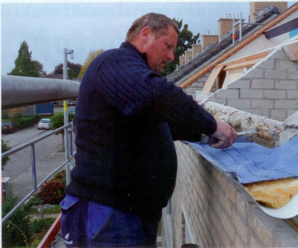
De bouwer plaatst bij een aansluiting tussen gevel en dakelement eerst de dakvoetrups...
